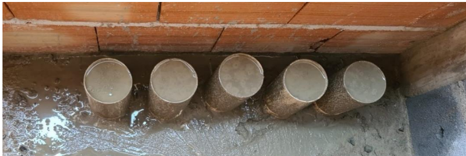
Figura 4 – Excesso de água nas amostras de concreto produzido em betoneira.
