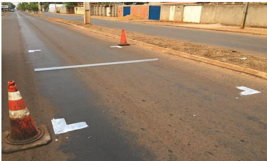
Figura 17 - Deslocamento de severidade baixa.
