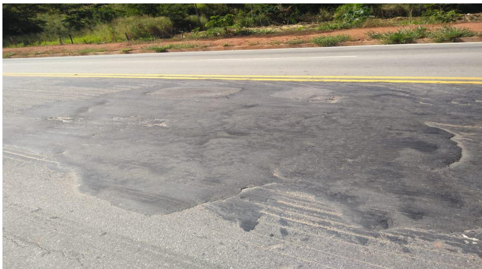
Figura 16 - Deslocamento de severidade alta.
