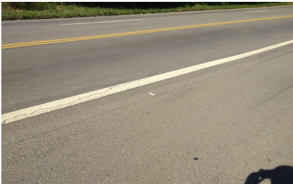
Figura 7 – Trinca Isolada Longitudinal – BR 116.
