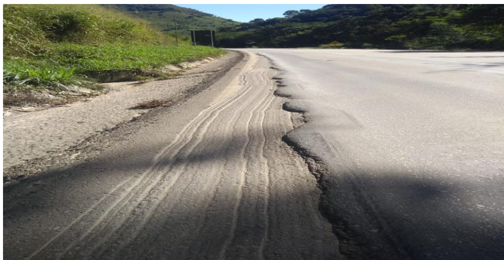
Figura 14 - Deslocamento de severidade baixa.
