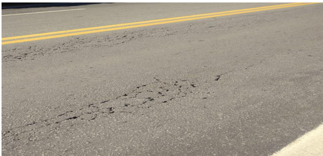
Figura 12 - Trincas por fadiga de severidade média Fonte: BR 116, 2020.
