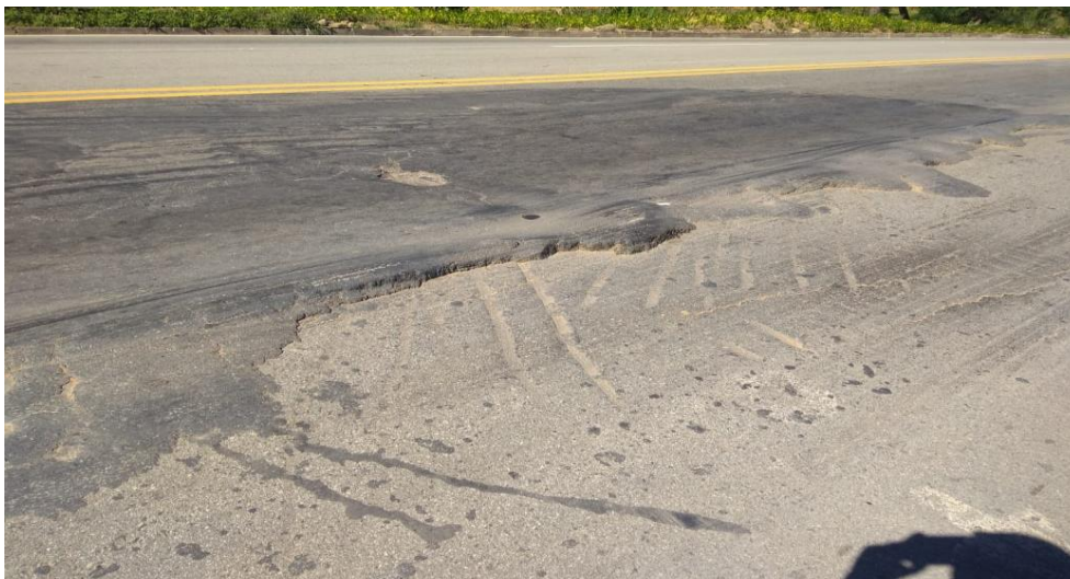
Figura 15 - Deslocamento de severidade média.
