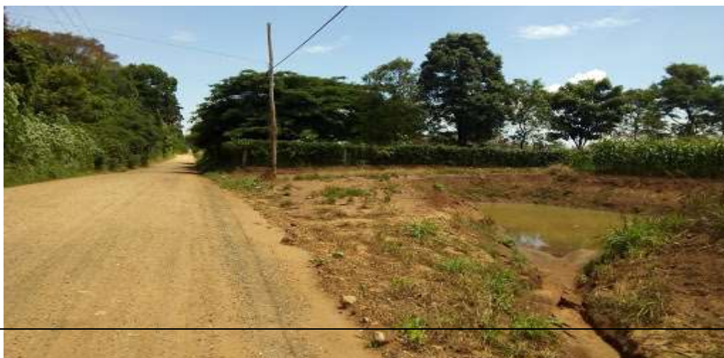
Figura 4 - Sistema de Drenagem em Estrada não Pavimentada.
