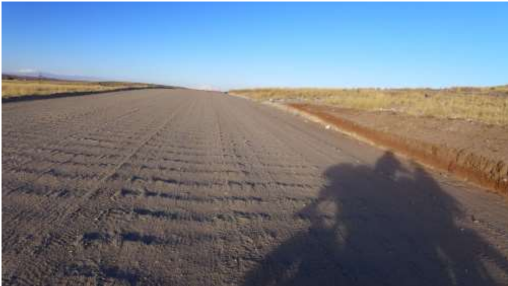
Figura 8 – Corrugações em estrada vicinal.
