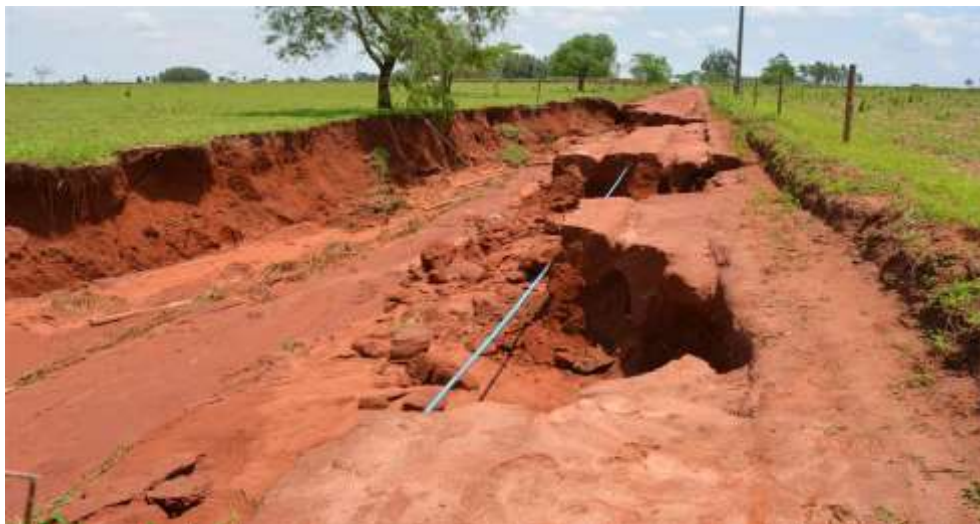
Figura 10 – Erosão em via não pavimentada.
