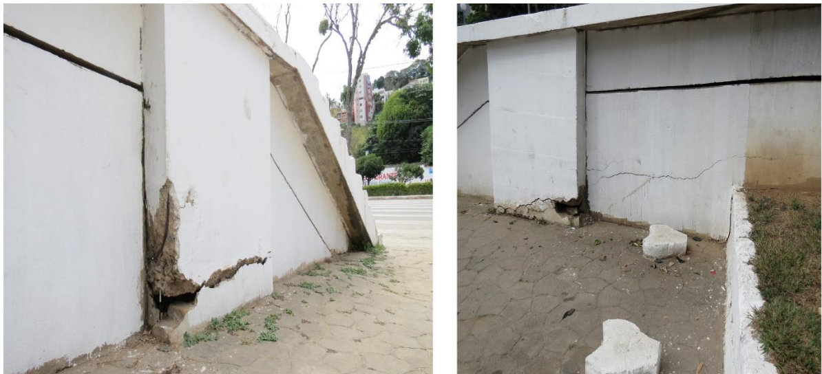
FIGURA 9- Rachaduras por toda a estrutura da rampa
