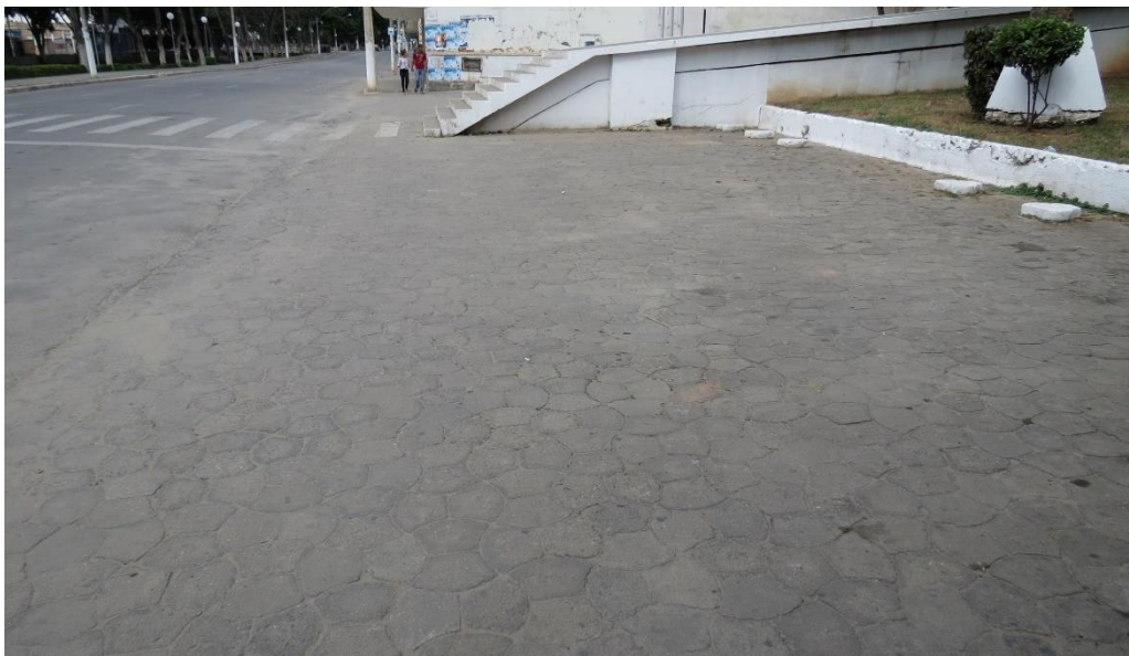
FIGURA 1 - Piso com Irregularidades, passeio no mesmo nível da avenida e estacionamento, trazendo insegurança a quem transita pelo local.
