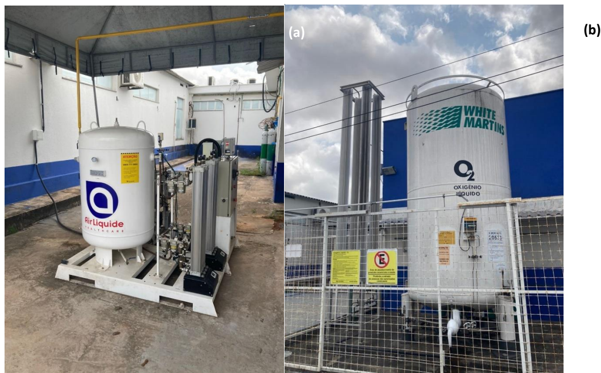
Figura 11: Unidades de armazenamento de (a) ar medicinal e (b) tanque criogênico de oxigênio localizado no Hospital Genésio Rego
