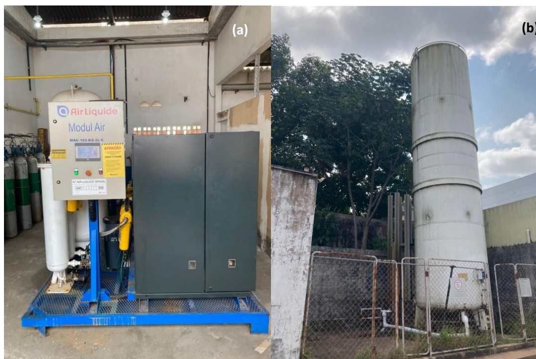
Figura 12: Unidades de armazenamento de (a) ar medicinal e (b) tanque criogênico oxigênio localizado no Hospital Carlos Macieira
