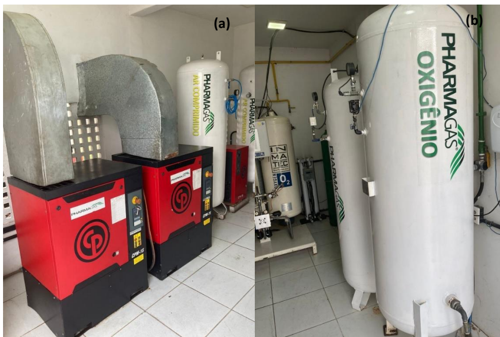
Figura 10: Unidades de armazenamento de (a) ar medicinal e (b) oxigênio localizado na Unidade de Pronto Atendimento de Paço do Lumiar
