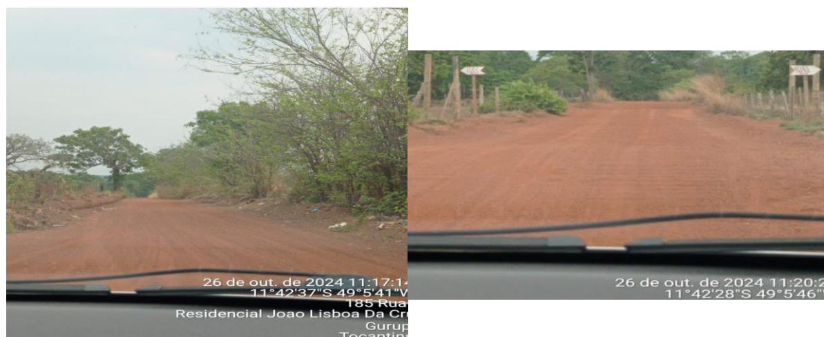
Figura 11: Ausência de dispositivos de drenagem na estrada Barroquinha, Gurupi-TO.
