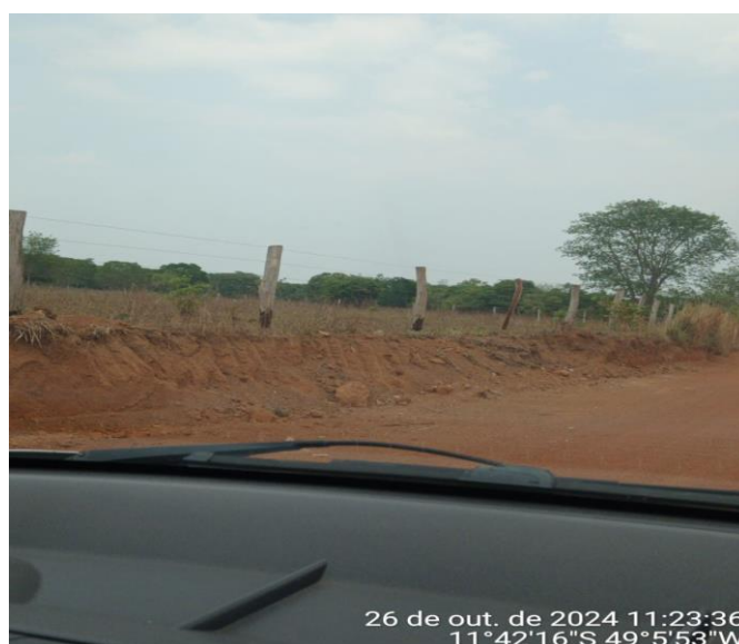
Figura 12: Trecho da estrada Barroquinha em processo de erosão.
