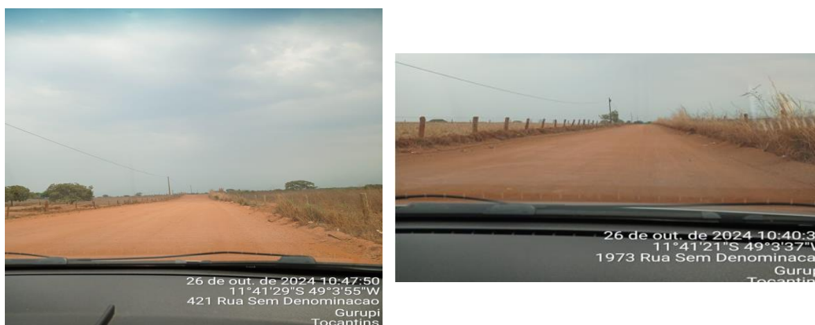
Figura 14: Ausência de dispositivos de drenagem na estrada Avenida Parque, Gurupi-TO.
