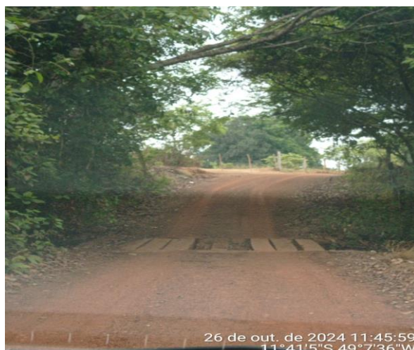
Figura 13: Ausência de defensas na ponte da estrada Barroquinha, Gurupi-TO.
