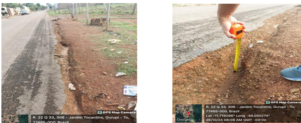
Figura 9 – Identificação de ravinas na infraestrutura do pavimento na Rua 22 do Setor Jardim Tocantins, Gurupi-TO.
