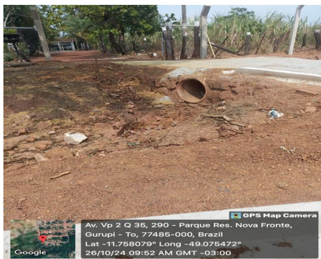
Figura 13 - Voçoroca causada pela má instalação de dispositivos de drenagem.
