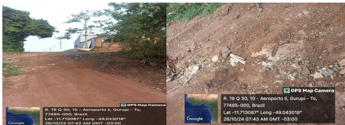
Figura 12 - Trecho da Rua 19 com indícios de processos erosivos reparados de forma improvisada, Gurupi-TO.
