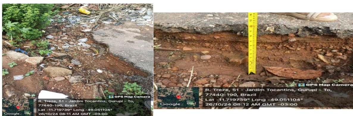
Figura 8 – identificação de Ravinas na Rua Treze no Setor Jardim Tocantins, Gurupi-TO.
