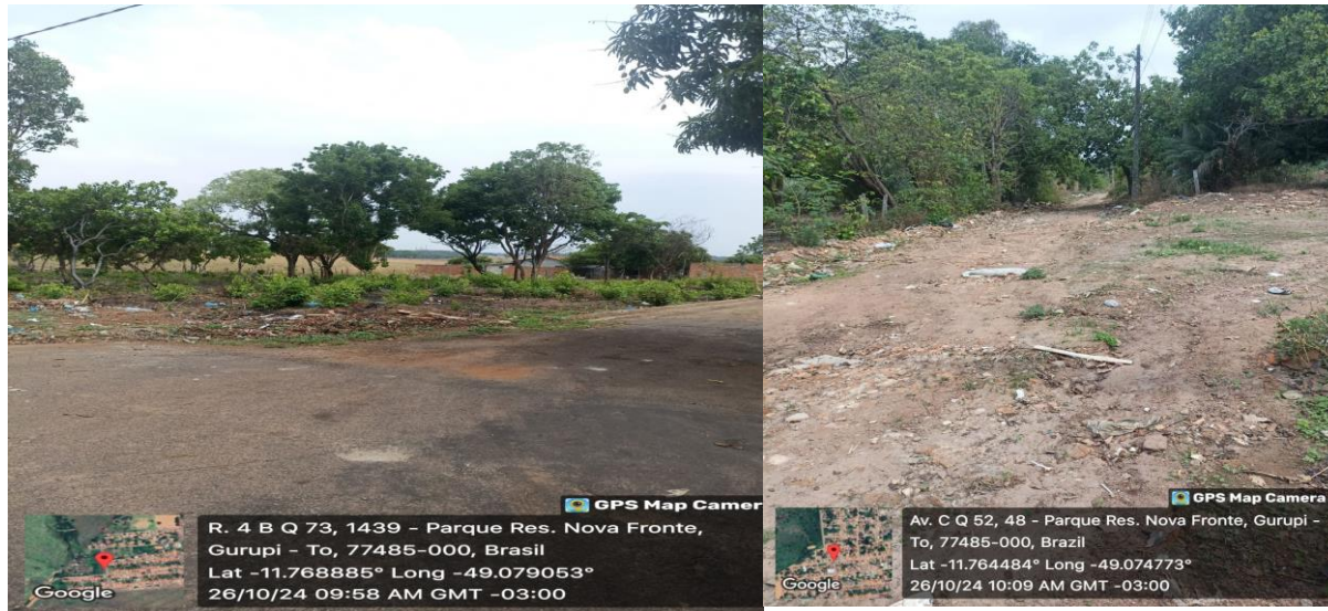
Figura 14 - Áreas de potencial erosão no Setor Parque Residencial, Gurupi-TO.
