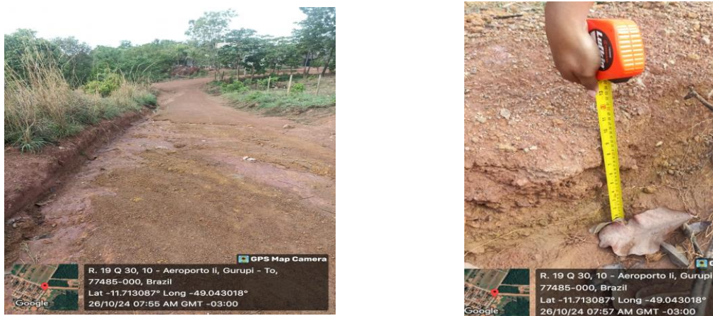
Figura 11 - Identificação de Ravinas nas Rua 19 do Setor Aeroporto II, Gurupi-TO.
