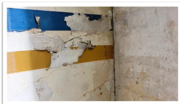
Foto 14: Descolamento de pintura de parede lateral externa
