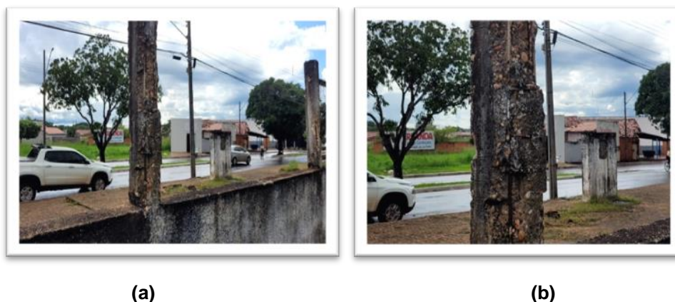
Fotos 12: Armaduras de aço expostas
