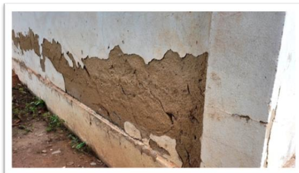
Foto 15: Desagregação na parede lateral externa
