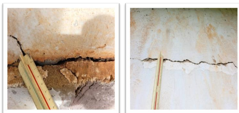
Fotos 10: trincas horizontais
