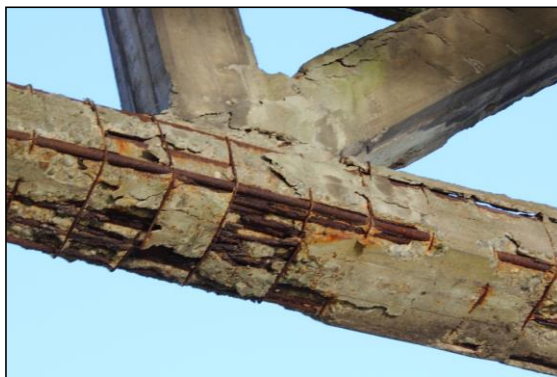
Foto 1 - Degradação do concreto armado por carbonatação.
