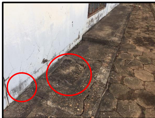
Figuras 12: Pontos de eflorescência.
