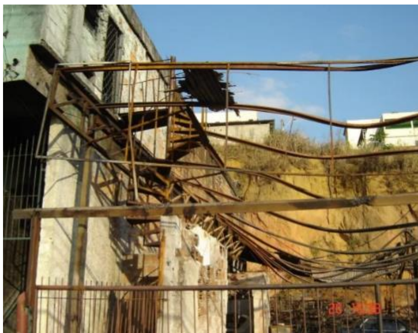
Figura 3 – Processo de Deformações excessivas – colapso da estrutura causado por incêndio
